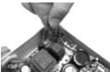
Câbles du moteur sur inverter
