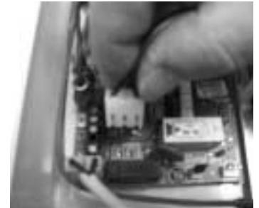
Den Leistungsverbinder des Inverters in den J17 einstecken
